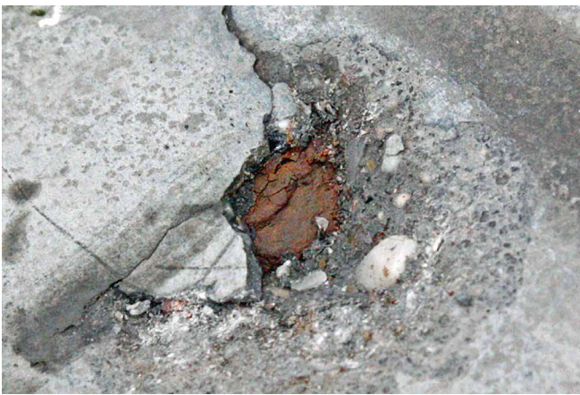
Abb. 4 a+b+c: Betonabwitterungen an optisch hochwertigen Bauteilen aus Beton
