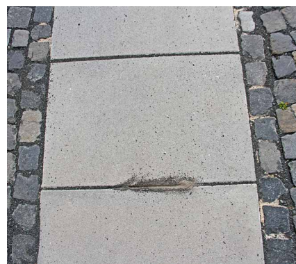
Abb. 2: Fugenmörtel mit geringer Festigkeit
