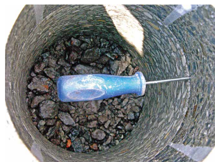
Abb. 7: Fehlender Verbund zwischen Fundamentbeton und Rinne
