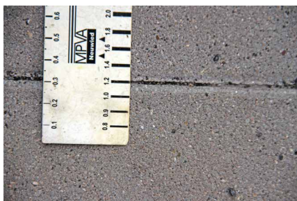
Abb. 4: Fugen mit sehr geringer Fugenbreite
