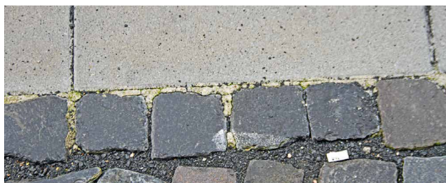
Abb. 3: Risse im und Ausbrüche am Fugenmörtel
