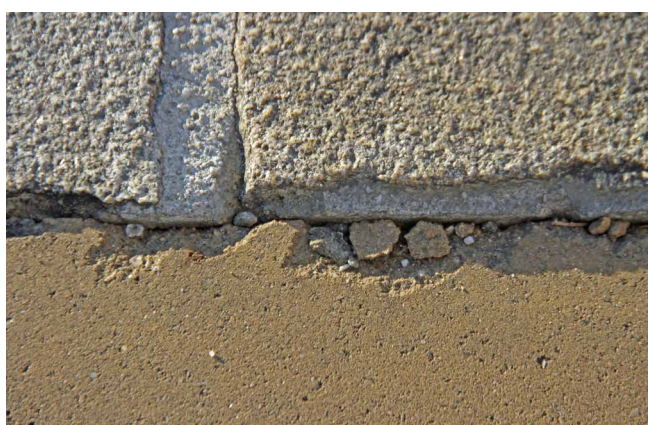
Abb. 8 a+b: Ausbrüche an den Randsteinen der gebundenen Pflasterdecke
