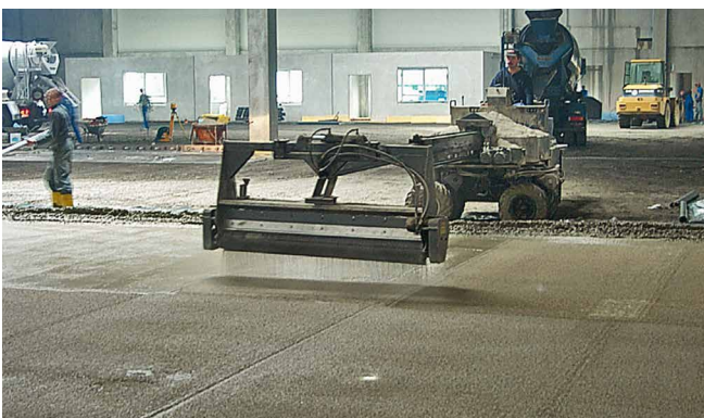
Abb. 1: Unter Verwendung einer Hartstoffeinstreuung hergestellter Industrieböden
