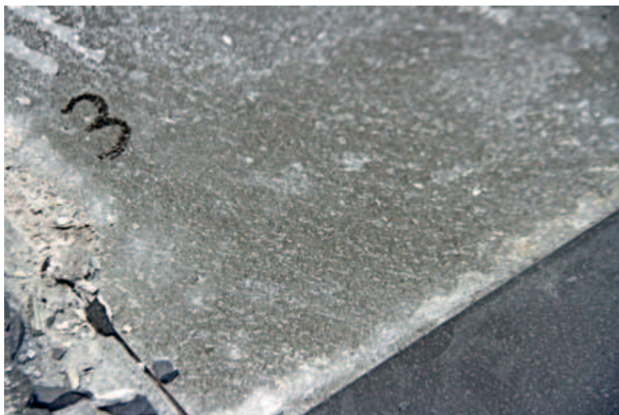
4 Trennlage auf der Bodenplatte durch zu dicke harzhaltige Grundierung
