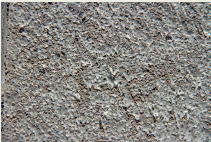
5 Zersetzungserscheinungen bei harzhaltiger Grundierung
